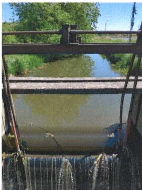
Fot. 3. Jaz piętrzący na Małej Wełnie na wysokości Stawu Karolewo II w okolicach punktu P2
